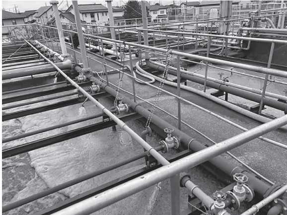
栃木レザーの曝気槽
